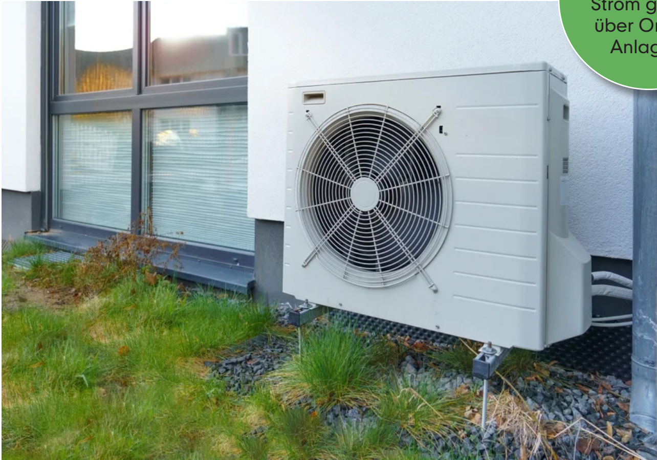
Abb. 12: Beispiel für eine Wärmepumpe mit Kühlfunktion; Bildadresse: https://waermemitzkonzept.de/wp-content/uploads/2025/07/shutterstock_2599840501-1.jpg
